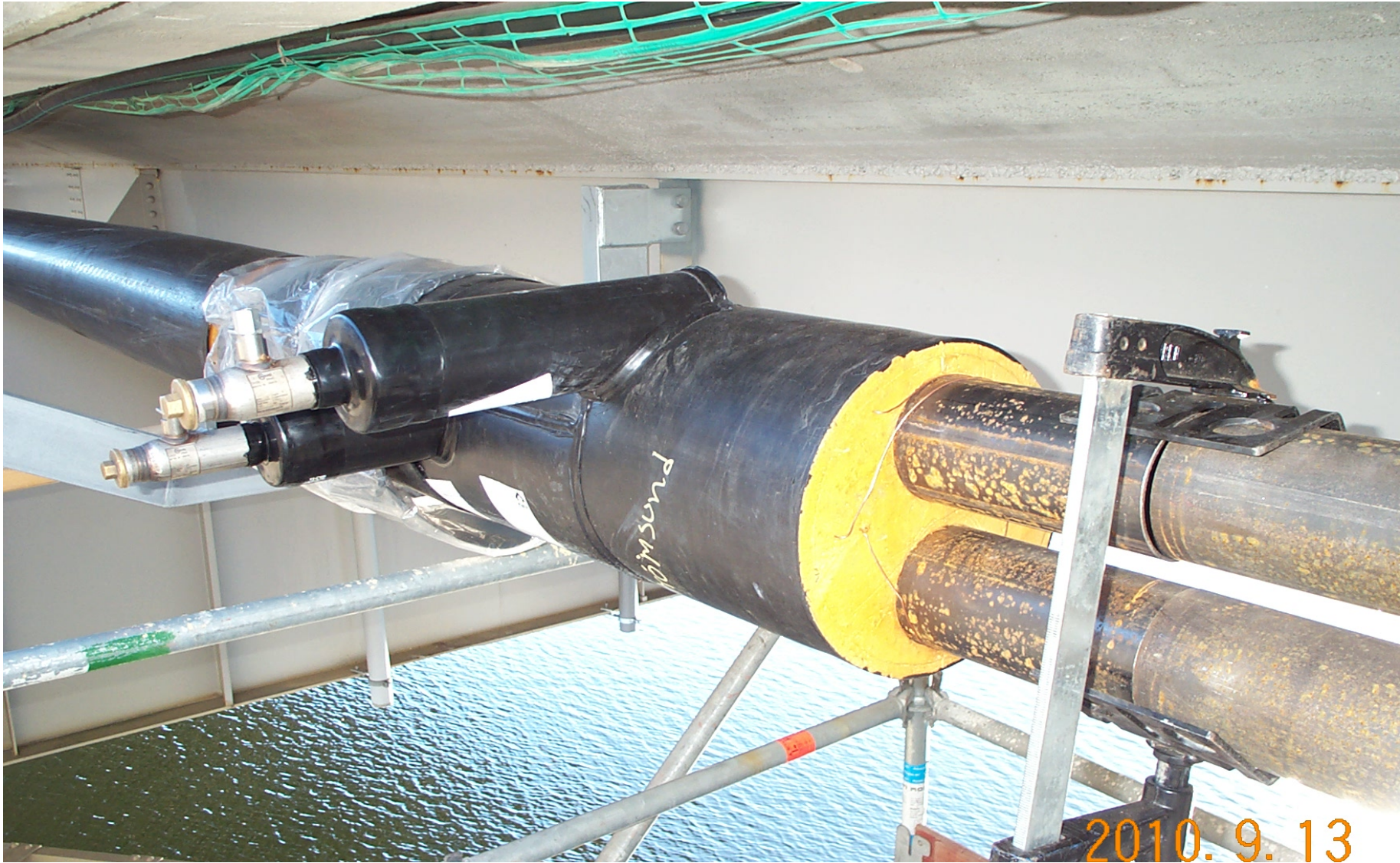
Specialavluftare på högsta punkten för att ingen luft ska hindra flödet..
