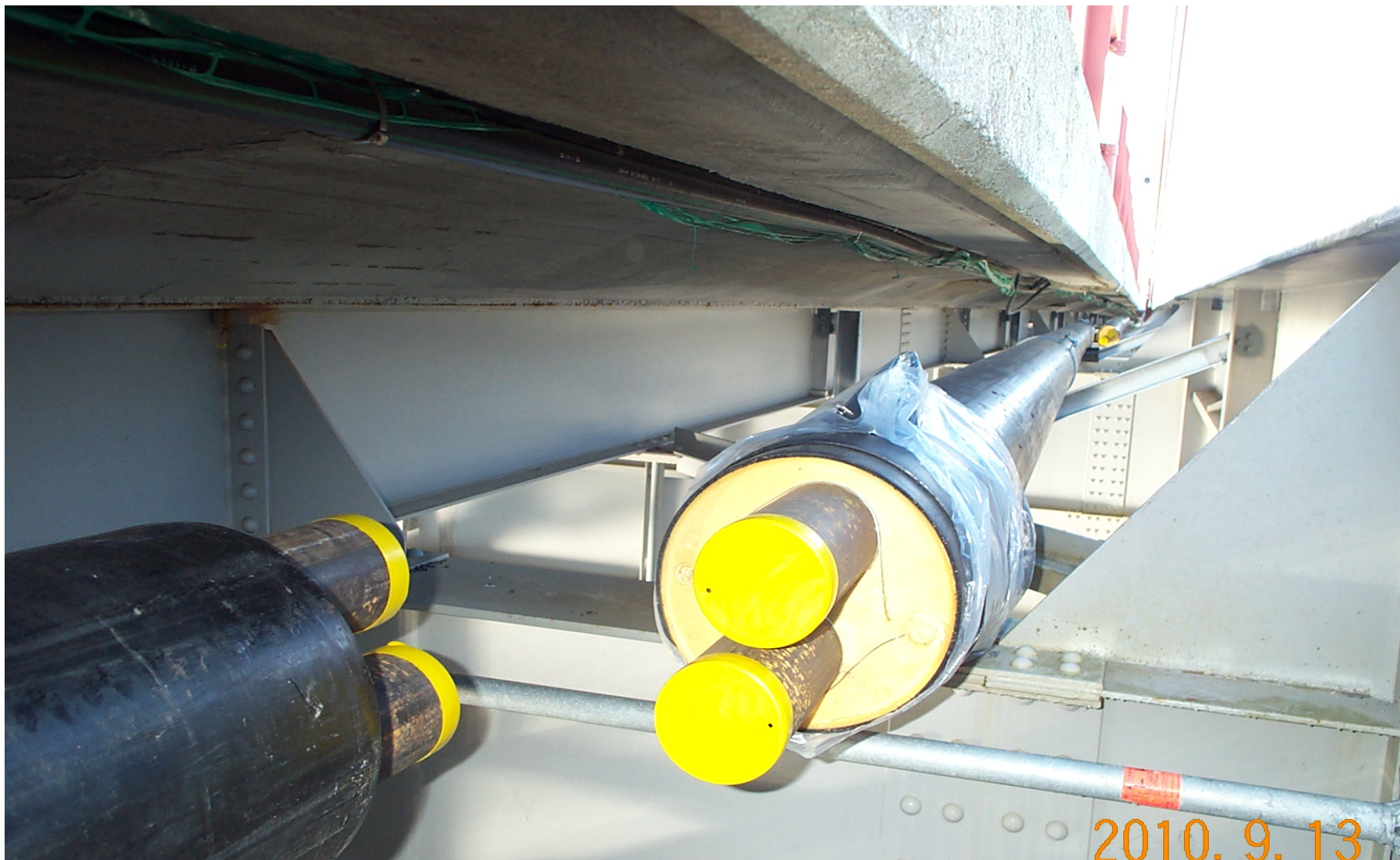
Kulvert DN100'2/315mm försörjer upp till 350 villor. Värmeavgivningen är c:a 15kWh/m. Röret (materialet) väger 30,8kg/m och innehåller 78liter vatten/m, totalt ~110kg/m.
